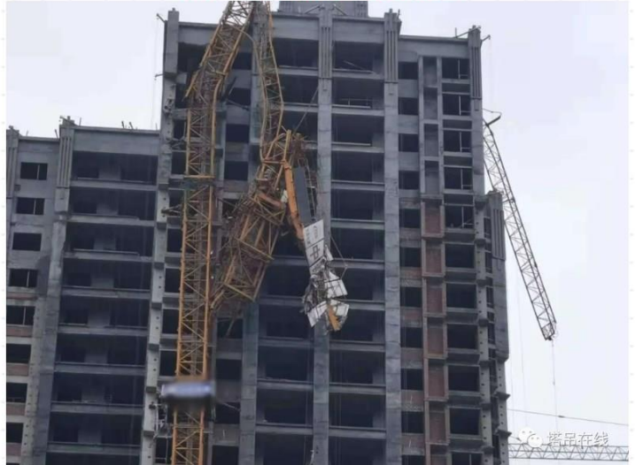
2020年5月21日上午湖南长沙梅溪湖一在建工地塔吊施工作业时发生折断倒塌事故。据网友称，该塔吊是在拆除爬架的过程中塔机标准节断裂发生倒塌事故，具体事故原因还在调查中。
